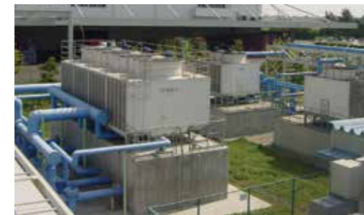
水循環設備 (板倉工場)
