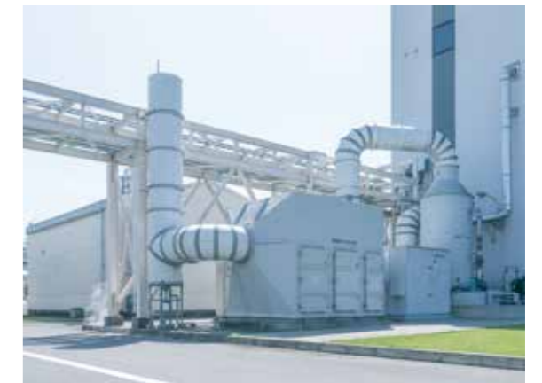
脱臭設備（板倉工場）
