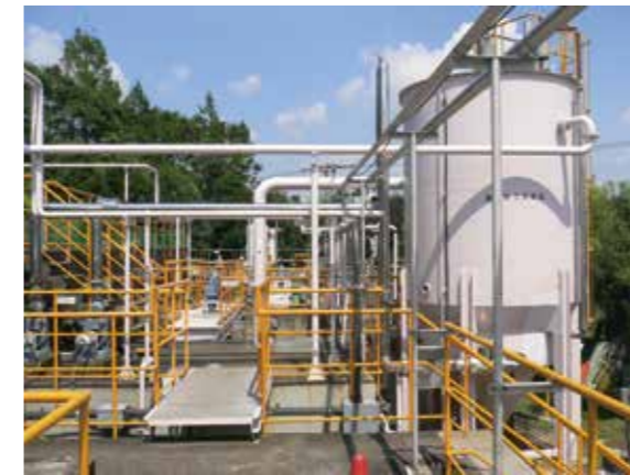
排水処理施設（板倉工場）
