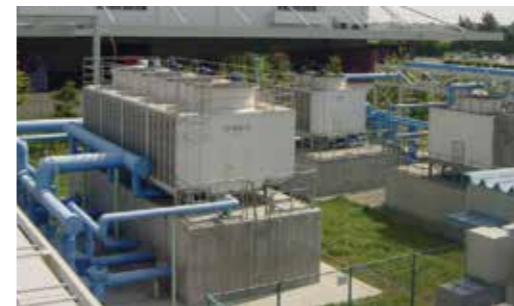
水循環設備 (板倉工場)
