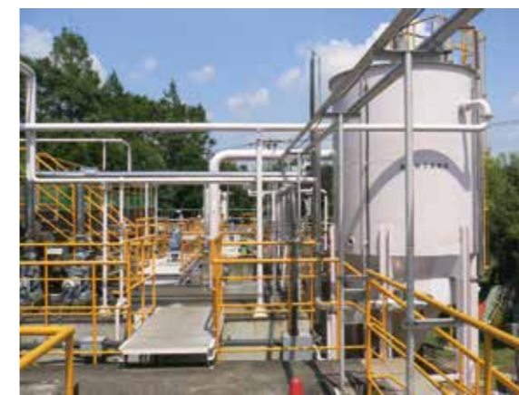
排水処理施設（板倉工場）
