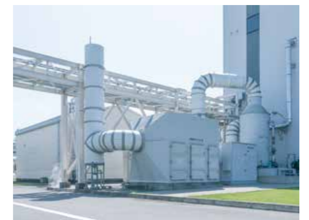
脱臭設備（板倉工場）
