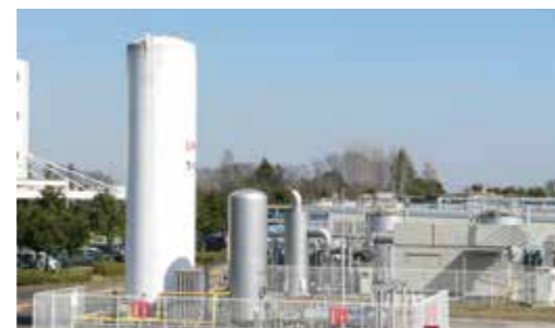
コージェネレーション (LNG) 設備 (板倉工場)
