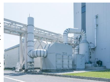
脱臭設備（板倉工場）
