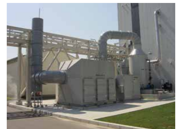
脱臭設備（板倉工場）
