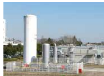
コージェネレーション (LNG) 設備 (板倉工場)
