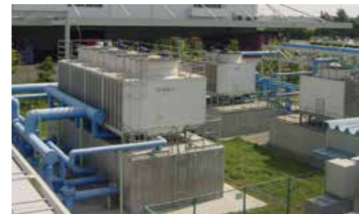
水循環設備 (板倉工場)
