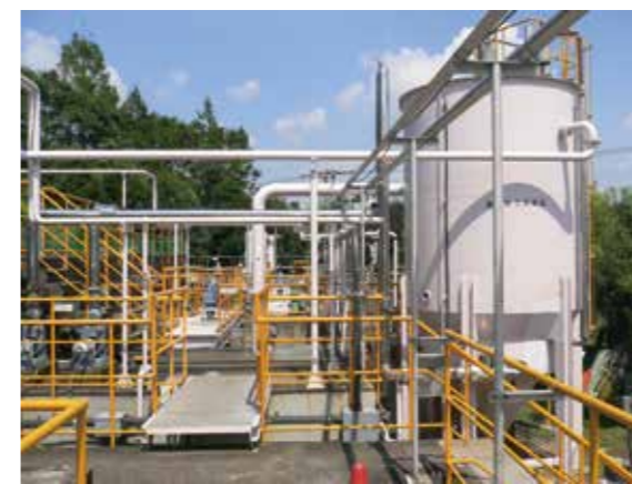
排水処理施設（板倉工場）
